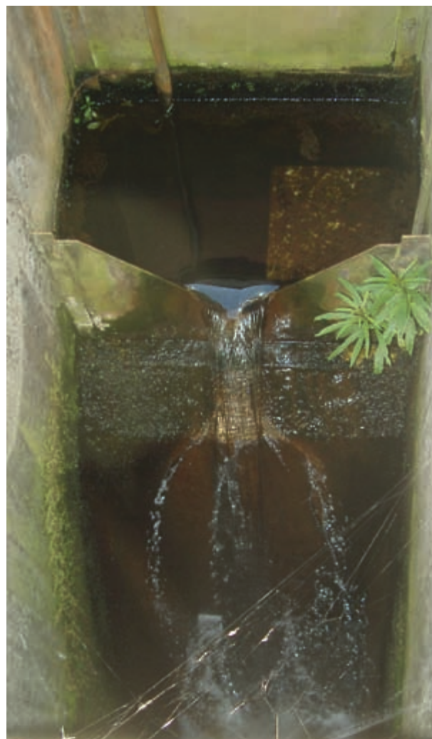
Interiör från avloppsreningsverket i Ekeby.
