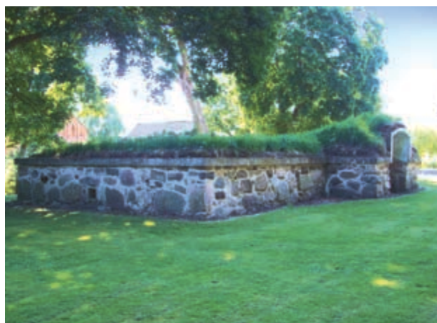
Kungsgården Ruinerna efter det gods som adelsmannen Jens Bille lät bygga 1571. Genom att dämma upp Bökebergsbäcken skapades en konstgjord sjö och på holmarna i sjön byggdes godset som fick namnet Billesholm. Vid rivningen 1955 bevarades källaren som idag är det enda som återstår av det ursprungliga Billesholm. Källaren är 7 x 10 m och består av tre rum.
